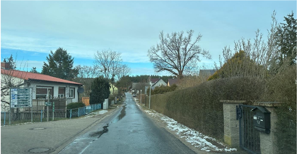
Abbildung 5 Fehlende Entwässerungseinrichtung, Spurrillen in der „Dagowseestraße“
